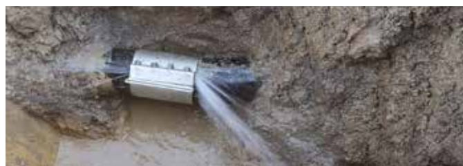
Ein unschöner Anblick: Rohrbruch an der Wasserleitung
